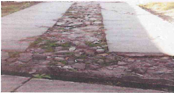
Foto 1: Estado actual de la torta de cemento.
