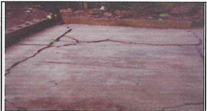
Foto 4: Area dañada de la torta de cemento.
