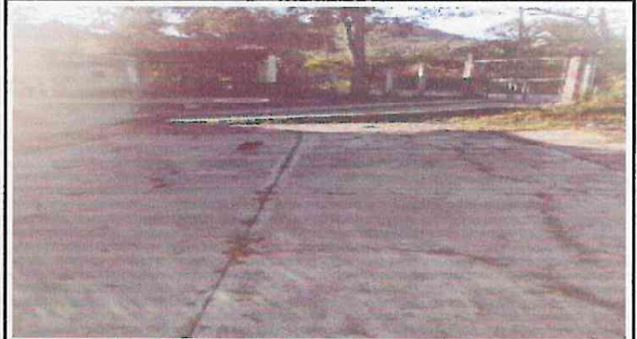
Foto 2: Estado actual de la torta de cemento.
