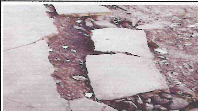
Foto 3: Area dañada de la torta de cemento.
